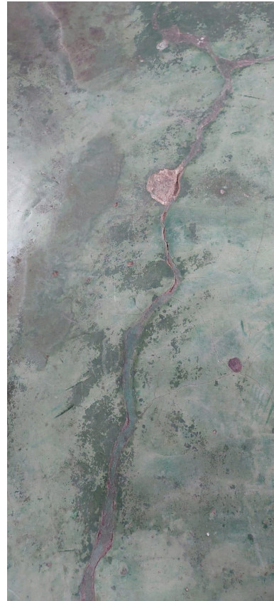
Trinca no piso da Capela Autoria: Maria Leticia Ticle Data: 15/02/2024
